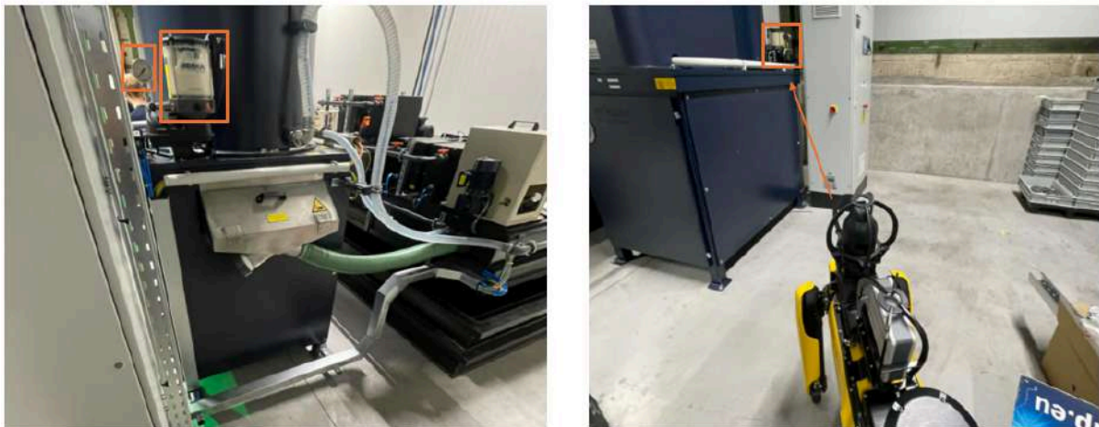
Figure 54 : problèmes sur la Z1000
