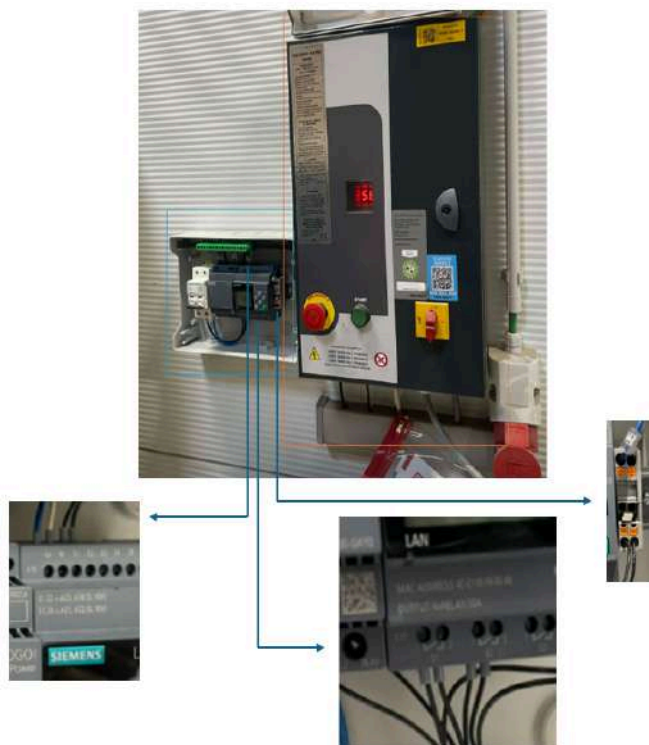
Figure 41 armoire d'un volet motorisé
